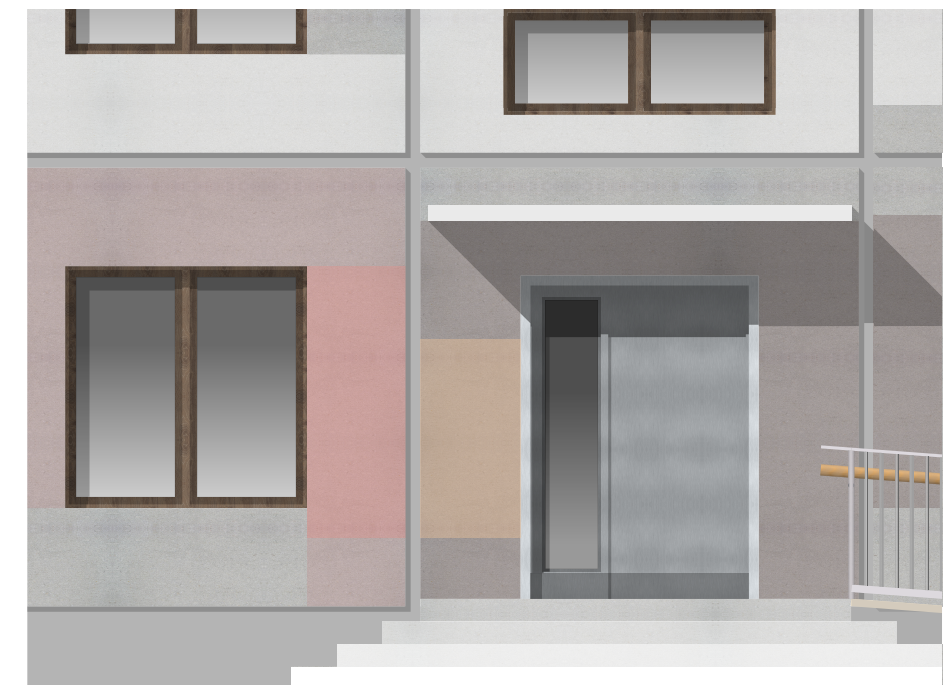
ПЛОХО. Цветовое решение фасада неоднородно, покраска стен выполнена хаотично с использованием разных оттенков одного цвета
