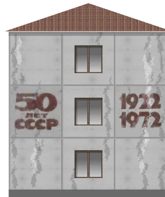
ПЛОХО. Исторические декоративные элементы фасада находятся в плохом состоянии, нуждаются в сохранении и реставрации
